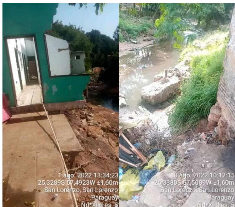
Figura 51. Imágenes de perdidas ocasionadas por desmoronamiento del terreno
